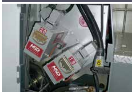
Vista forni I.R.-A.C. su torre di essiccazione I.R.-HOT AIR dryers on drying unit view
