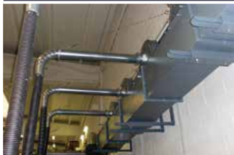
Vista tubazione di espulsione aria Air exhaust piping view
