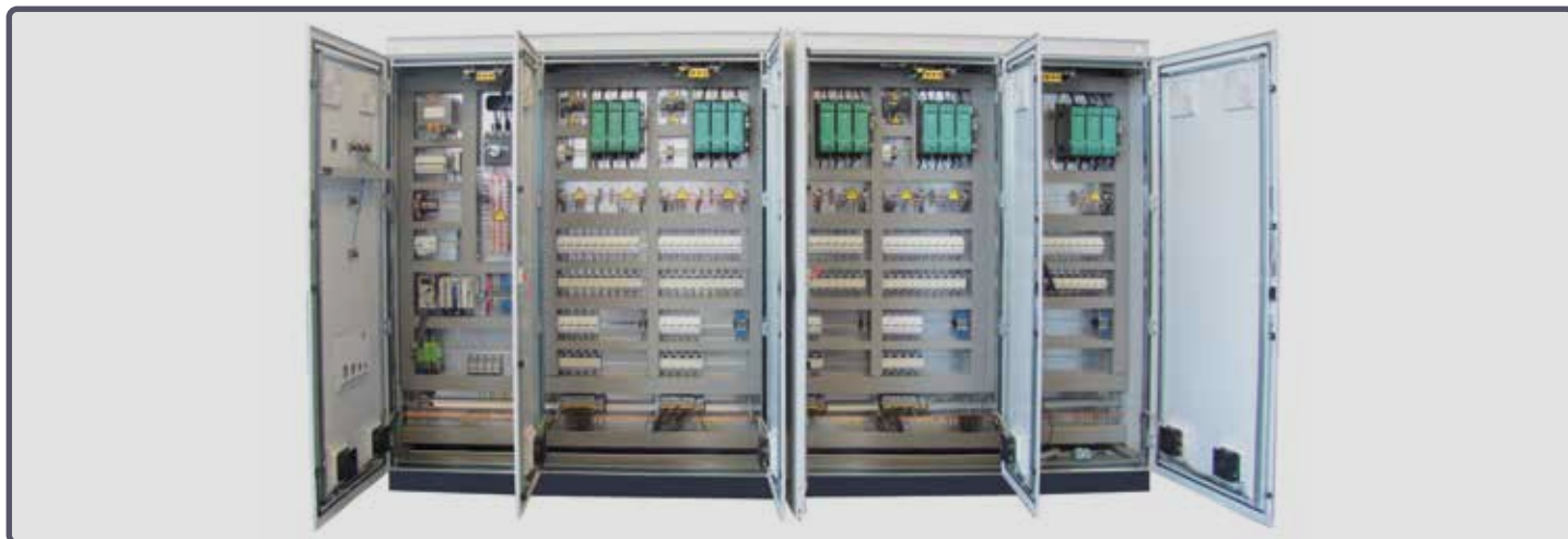
Vista armadio elettrico di comando Vue armoire électrique de contrôle
